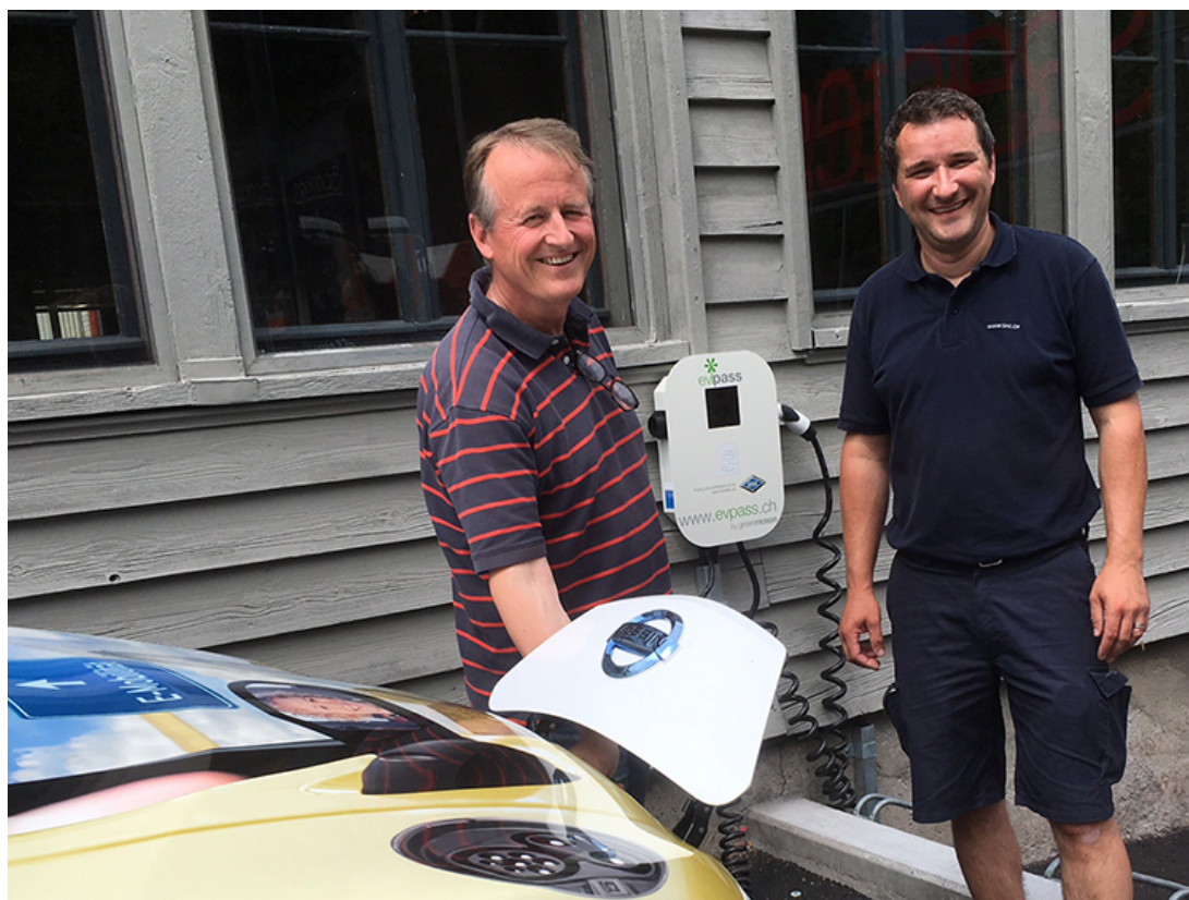
Freuen sich über die neu installierte Ladestation am Walensee: Dieter von Ziegler, Geschäftsleiter Restaurant Sagibeiz (links) und Andreas Aebli, Servicemonteur der SAK.
